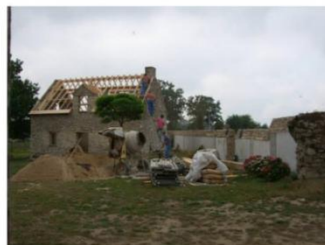
La maison avant travaux, avec sa charpente neuve reprenant le volume initial. © DR
